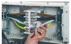
Проводники должны быть тщательно зачищены от окислов
