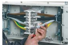
Проводники должны быть тщательно зачищены от окислов
