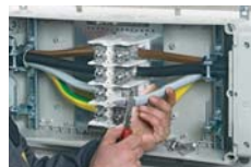
Проводники должны быть тщательно зачищены от окислов
